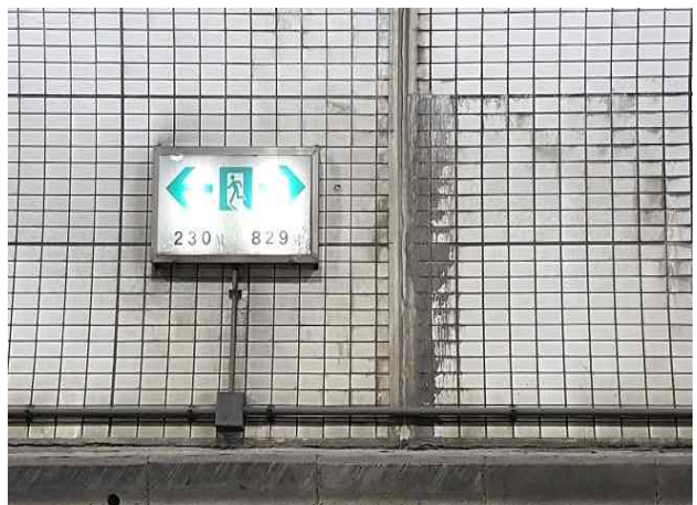
이음부 누수흔적 및 백태
